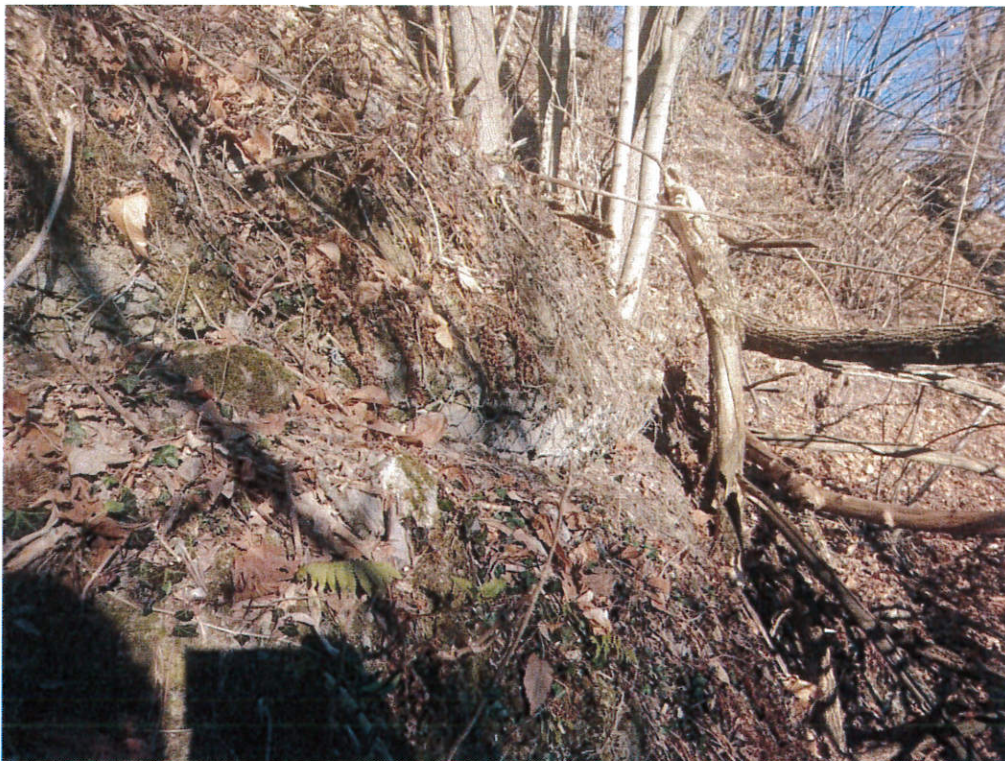
Foto 6 : Gabbione deformato nella parte centrale del corpo di frana, con accumuli di materiale ricolonizzato dalla vegetazione.
