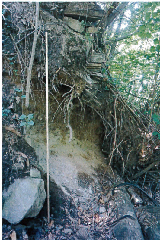
Foto 4 : Nicchia di stacco a valle del sentiero.
