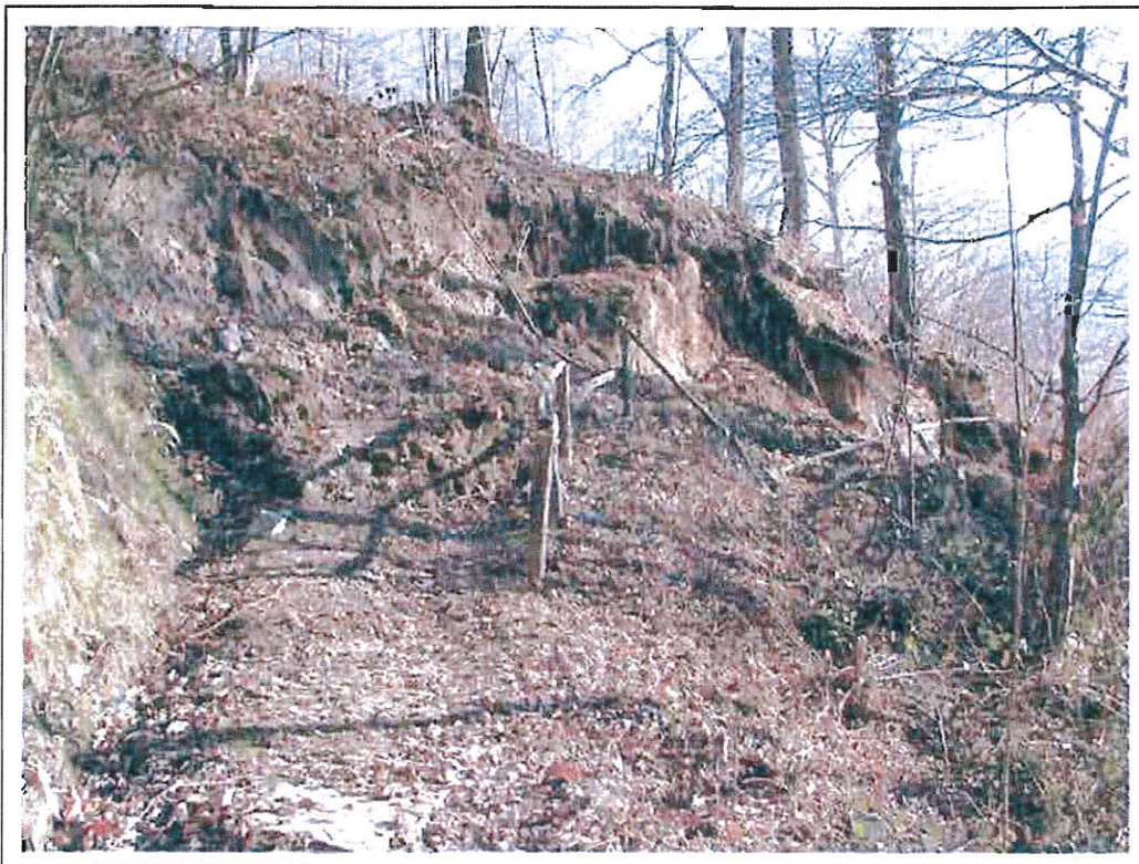
Nella foto è visibile la fessura perimetrale con un rigetto di quasi 2 m.
