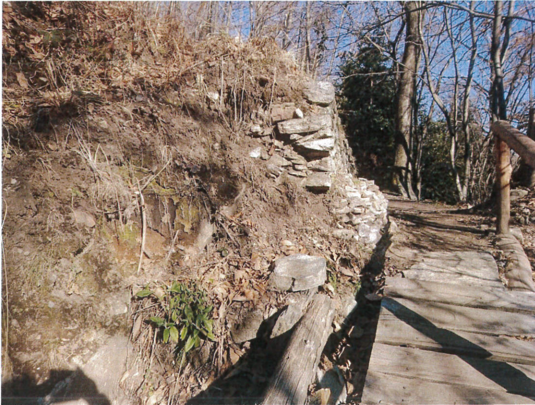
Foto 3 : Nicchia di stacco, immediatamente a monte del cassone in legno al limite orientale del dissesto.
