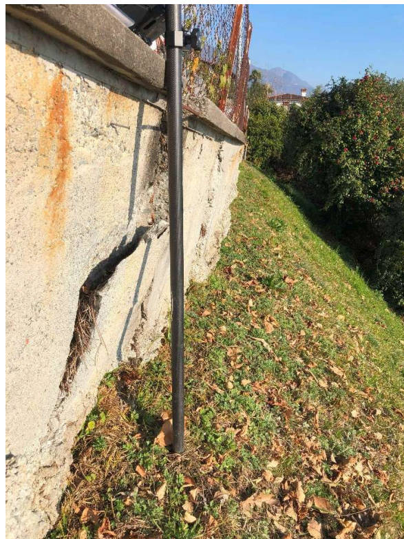
Foto 16: vista cedimento muro strada (v. foto no.7)
